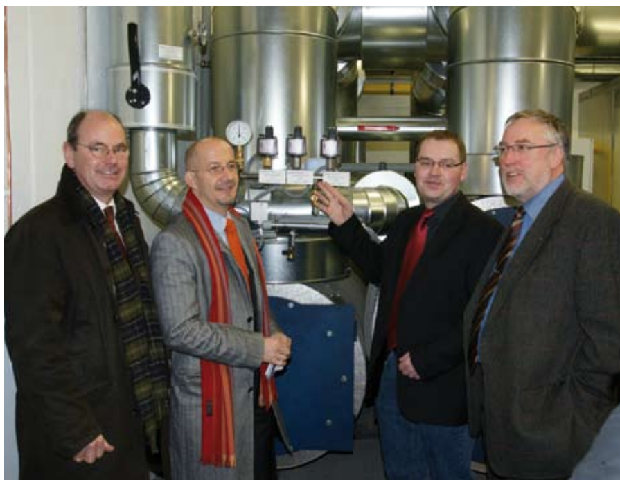
WIDI-Geschäftsführer Johannes Wittenbrink, WIDI-Aufsichtsratsvorsitzender Ralf Schwarzkopf, Betriebsleiter Christof Hackler und Detlef Seidel, Aufsichtsratsvorsitzender der Märkischen Kliniken bei der offiziellen Inbetriebnahme des neuen Blockheizkraftwerkes auf dem Klinikgelände in Hellersen.
