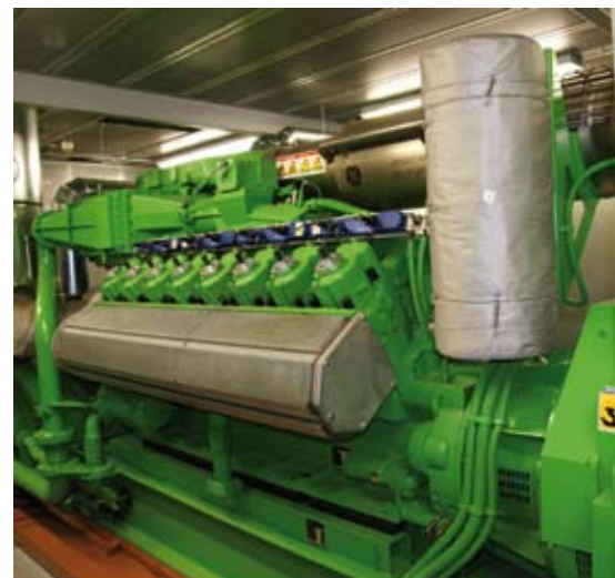
Das Herzstück der Anlage: Der BHKW-Motor-Generatorblock, bestehend aus einem Gasmotor und einem davon angetriebenen Generator.
