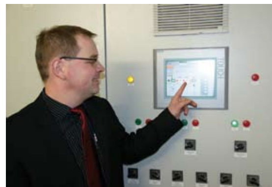
Die Steuerung des BHKW: Betriebsleiter Christof Hackler erläuterte die einzelnen Funktionen.
